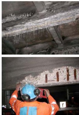
Skader på forpladsbroerne
