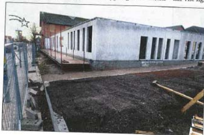
I dag begynder nedrivningen af disse råvægge til en skole grundet manglende CE-mærkning. (Foto: Torben Hansen)
