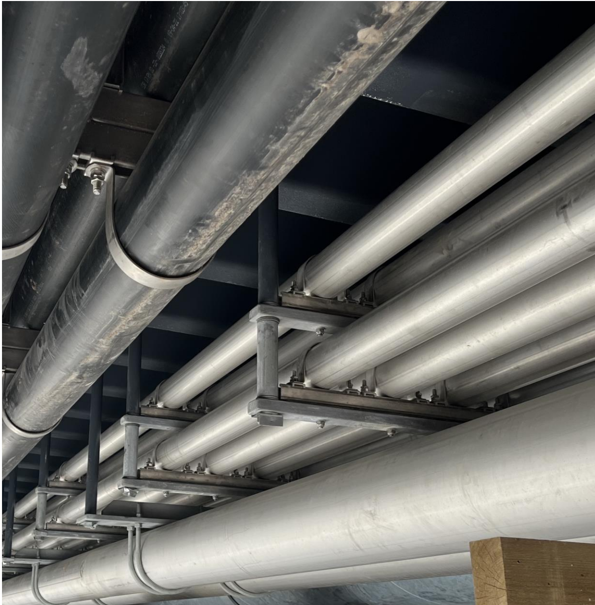
Rustfrie rør for EL
